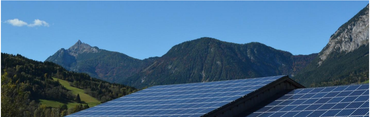
PV Anlage am Gewerbepark in Niederöblarn © Ernst Nussbaumer
